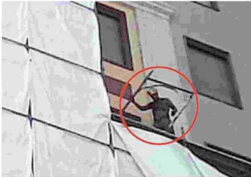
Un operaio sorpreso dal nostro fotografo con un carico sospeso su un ponteggio, senza imbragatura, in zona Porta Venezia
